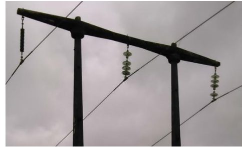
Figura 2. Torre contendo isoladores avaliados.
