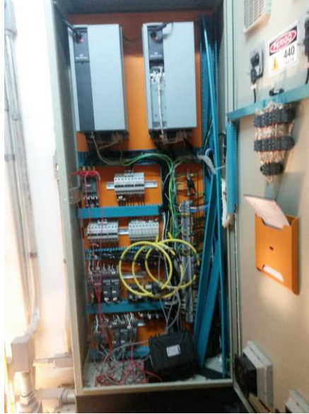
FIGURA 3: ANALISADOR DE QUALIDADE DE ENERGIA NO PAINEL DO VENTILADOR
