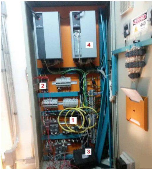
Figura 5: Painel do Ventilador com o Analisador Instalado
