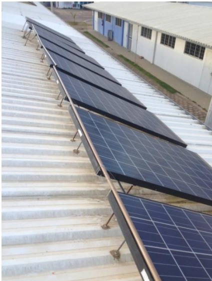
Fig. 8: Conjunto de painéis fotovoltaicos com o sistema de refrigeração instalado.
