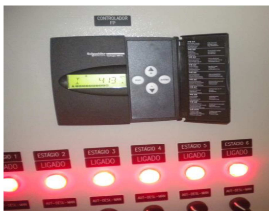
Figura 7. Corrente (em Ampères) do banco de um dos painéis com acionamento dos estágios.
