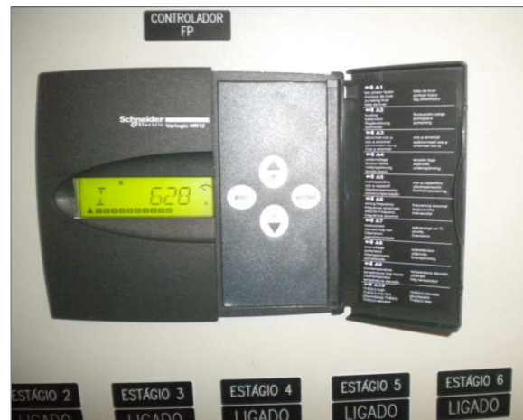
Figura 6. Corrente (em Ampères) do banco de um dos painéis sem acionamento dos estágios.
