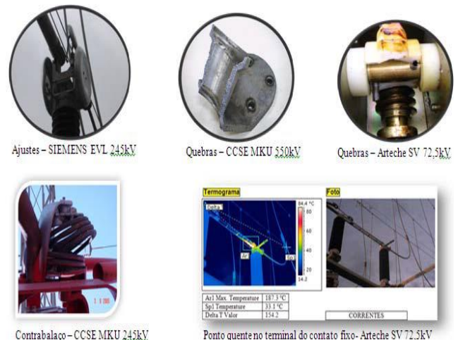
Figura 04: Problemas em chaves seccionadoras
