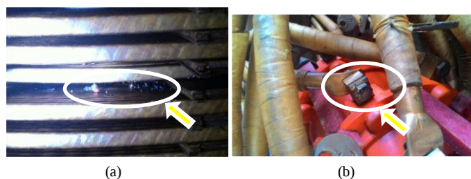
Fig. 2. Defeitos no transformador de potência retirado de operação por meio da aplicação de técnicas preditivas: a) grânulos de cobre; b) erosão no parafuso.
