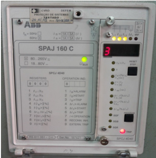
Fig. 7: Indicações após atuação do relé.
