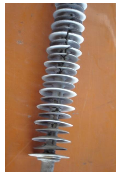
Figura 02 – Falhas em isoladores poliméricos.
