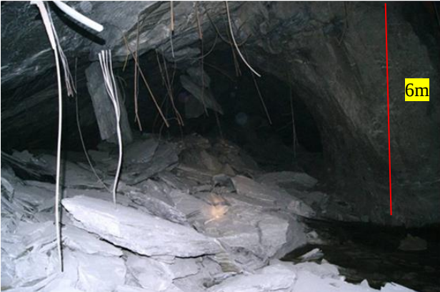
Figura 12- Visualização do colapso ocorrido no corpo 14 Serotinho.
