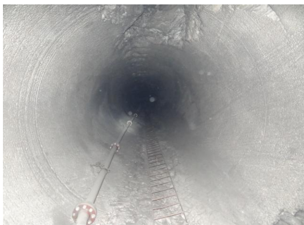
Figura 2. Quebras diametralmente opostas em shaft de ventilação, 800m de profundidade.
