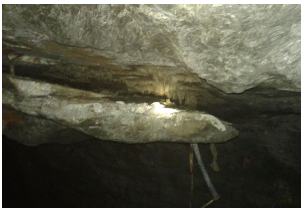
Figura 14: Evidência de fuga de mistura ligante pelas trincas.
