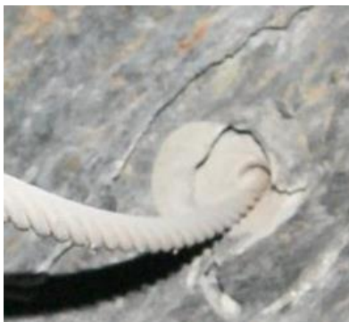
Figura 9: Evidência de cabos escorregados na capa (Hanging Wall), destacando a abertura entre cabo e mistura ligante.
