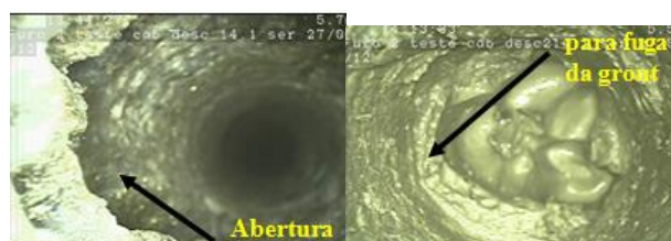
Figura 13: Evidência de que na metodologia de injeção descendente, a grout não “escapa” pela trinca.
