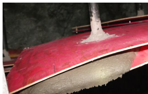
Figura 20: Comportamento da argamassa na trinca quando sem aditivo, impedindo que o furo seja totalmente preenchido.
