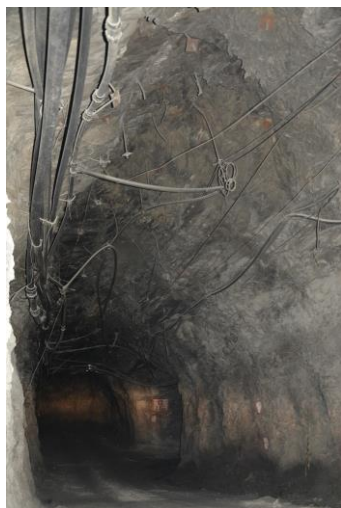
Figura 5: Evidência de overbreak ao longo do nível 13 da rampa FGS, sinalizando o “capelamento”.
