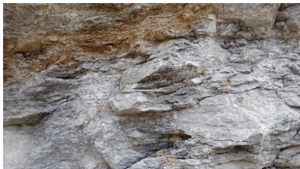
Figura 2. Zona Fraturada e Intemperizada da Face do Talude.
