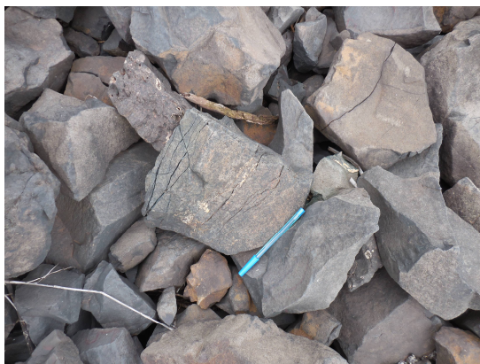
Figura 3 – Enrocamento em basalto com fissuras
