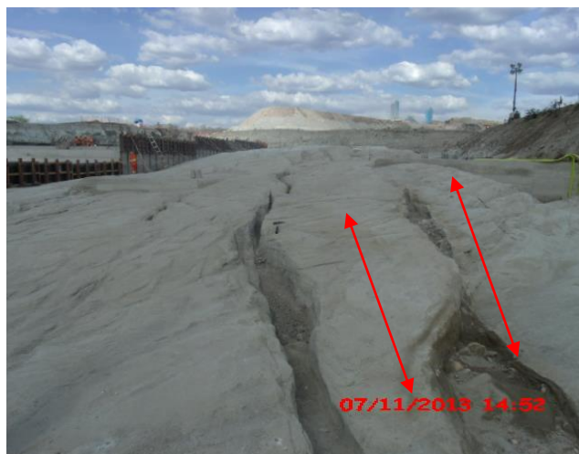
Figura 12 Vista das Falhas geradas por processos erosivos, mapeadas ao longo dos blocos 18, 19 e 20, no sentido longitudinal ao eixo. Superfície da escavação do vertedouro na cota da fundação de projeto.
