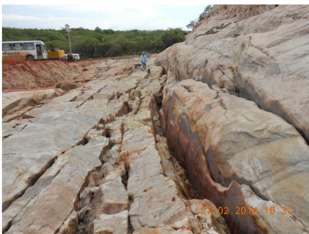
Figura 11 – Falhas geológicas causadas por erosão em planos de fraqueza da rocha, área interpretada pelos autores como associada a antiga cachoeira. Fundação no contato do maciço de terra com a ombreira esquerda
