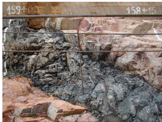
Figura 4. Dique diabásico na fundação do bloco 09 do vertedouro (Brasil, 1020-JI2-RT-VTC/GG-00054, 2011).
