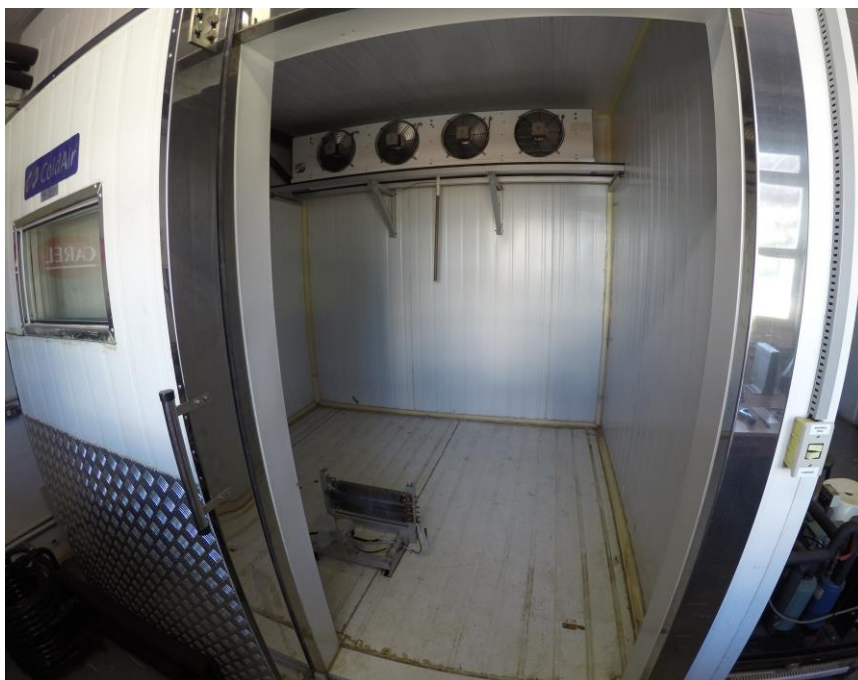
Figura 2: Fotografia da câmara fria, na parte de baixo desta a resistência elétrica utilizada para simular carga térmica.
