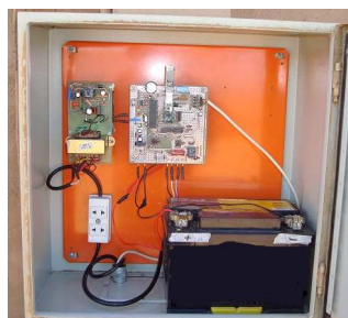
Figura 3: Central instalada (versão de teste)
