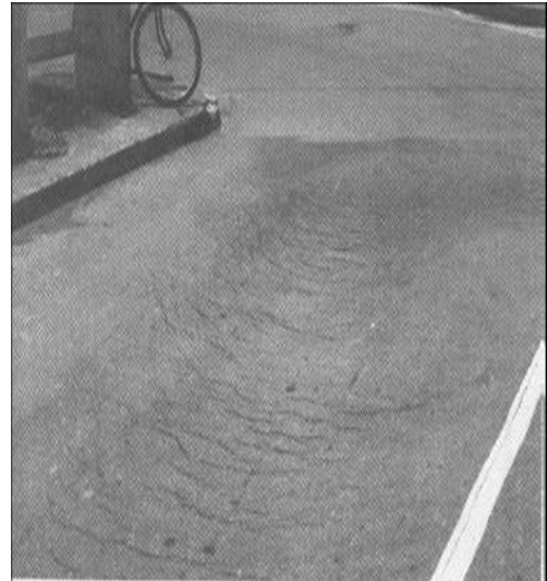
Figura 1b - Defeito provocado pelo deslocamento relativo entre as camadas
