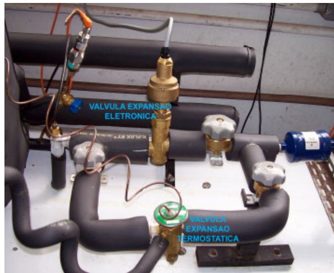
Figura 3. Foto da seção bypass entre a válvula de expansão eletrônica Danfoss ETS25 e válvula termostática no circuito principal de refrigeração.
