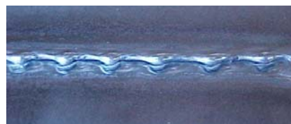
Solda em não conformidade (junta sobreposta)
