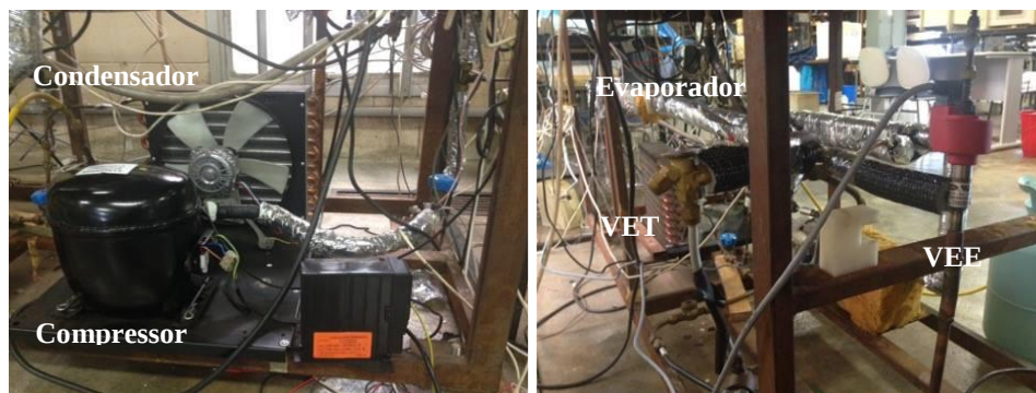
Figura 2. Circuito básico de refrigeração da bancada experimental
