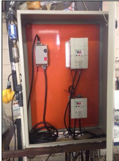
Figura 7. Painel dos inversores de frequência utilizado na bancada experimental
