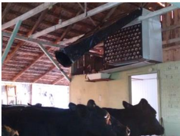
Foto 6 - Climatizador em operação.
