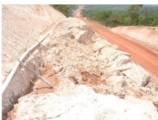
Figura 12. Trecho de ruptura no talude do Corte 25.
