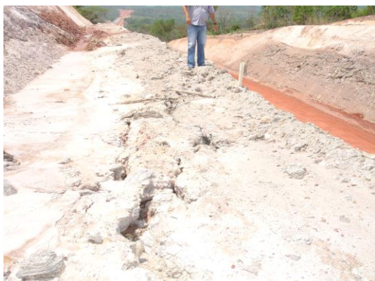
Figura 8. Trincas de tração em berma do Corte 25.
