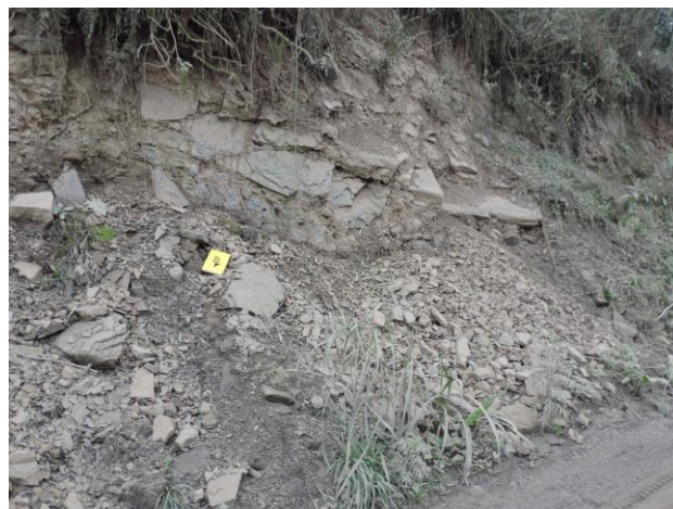
Figura 9. Talude de corte em rocha e solos residuais do folhelho no km 176. Folhelho cinza escuro, com elevada desagregação, além de intenso deslocamento seguindo a orientação da camada.
