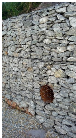
Figura 10. Tubo de drenagem da Contenção IV.
