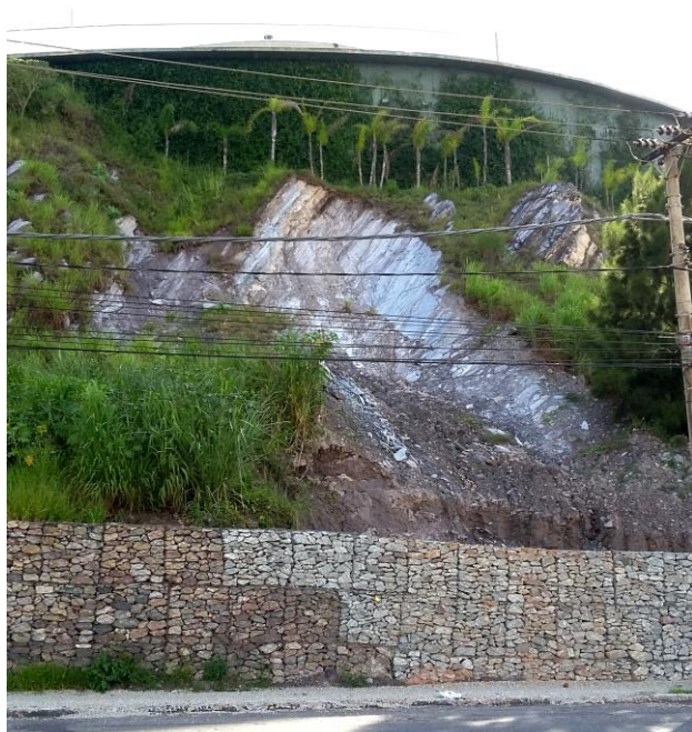
Figura 8. Vista do talude da Contenção IV, com o detalhe para a ruptura.
