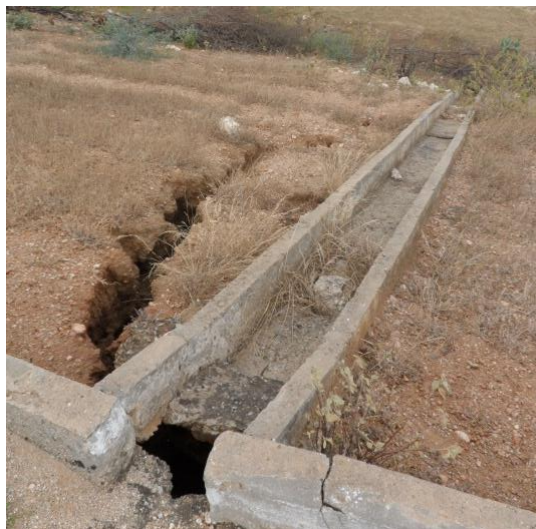
Figura 11. Trinca identificada no talude de jusante da barragem do açude Dourado
