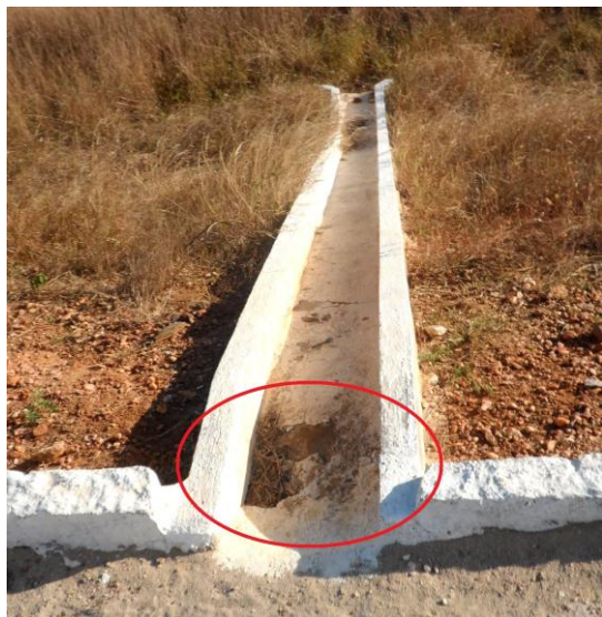
Figura 10. Canaleta danificada na barragem de Cruzeta
