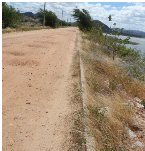
Figura 8. Meio-fio e afundamentos identificados no coroamento da barragem do Boqueirão de Parelhas
