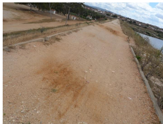
Figura 9. Meio-fio e afundamentos na barragem do Açude Dourado
