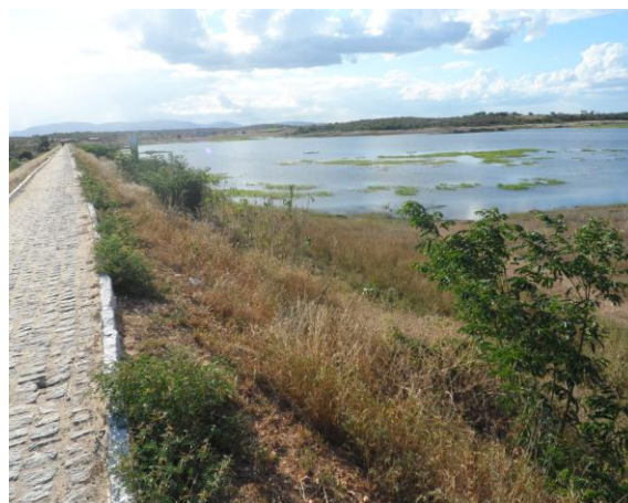
Figura 2. Vegetação no talude de montante da barragem de Cruzeta
