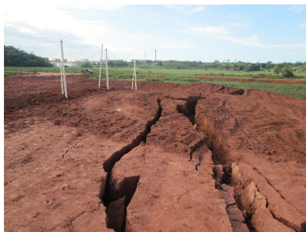
Figura 3. Detalhe das trincas no plator do aterro 2 (Nascimento, 2016)
