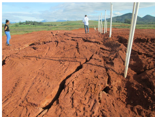
Figura 2. Ruptura do Aterro 2 (Nascimento, 2016)
