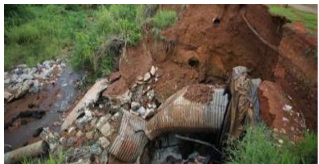
Figura 6. Área após processo de ruptura.
