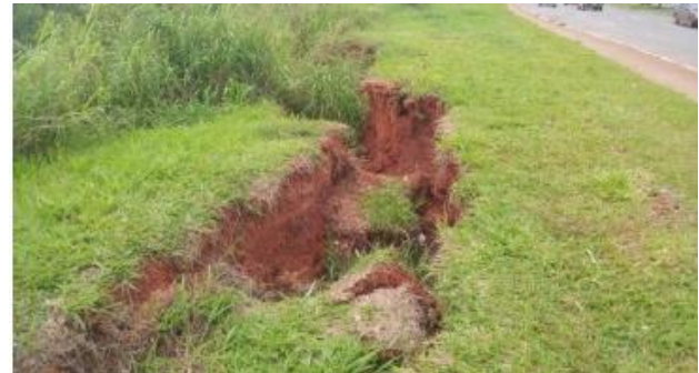
Figura 4. Talude em processo de ruptura.
