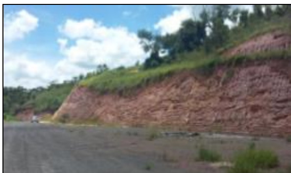
Figura 2 - Feições erosivas no talude de corte do Cultural (AUTORES, 2015).
