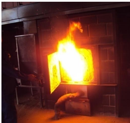
Figura 08: Fornalha do forno com o queimador (equipamento), onde encontramos uma chama horizontal em um forno túnel.
