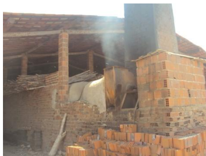
Figura 11: Exaustor na base da chaminé com vazamento da fumaça branca.
