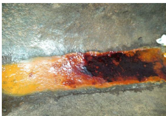
Figura 7.3 Fotografia do início de corrosão do aço.
