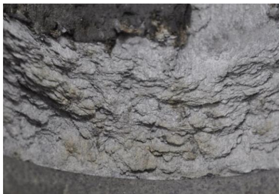
Figura 2.2 Fotografia do tipo de esfoliação presente na tubulação no primeiro estágio.
