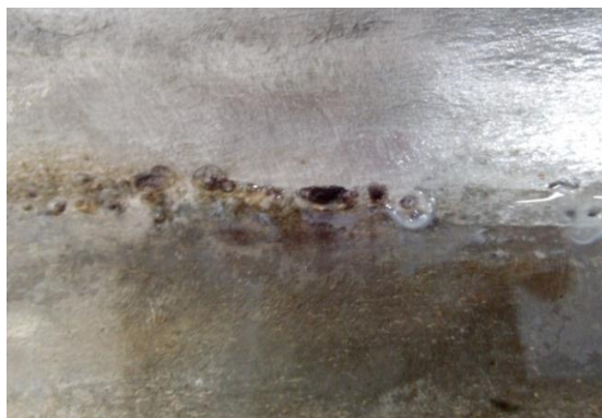
Figura 4. Fotografia a corrosão do alumínio
