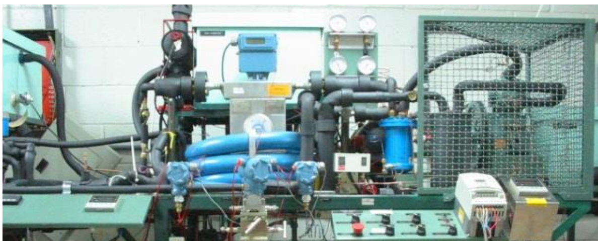
Figura 1. Vista geral da máquina de refrigeração (Duarte, 2014)
