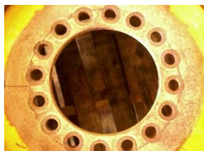
Figura 2. Área trincada próximo aos furos de fixação dos parafusos do Aro da 938H.
