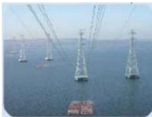
Figura 1. Exemplo de linhas de transmissão marítima com cabos de alumínio termorresistente. Fonte: OHM TEKMIN, 2006.
