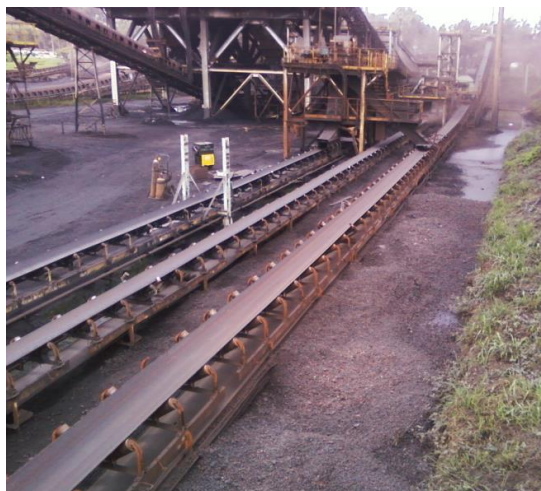
Figura 7. Acúmulo de Material ao Longo do Transportador de Minério Granulado. Fonte: Autor
