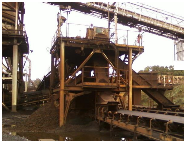
Figura 5. Vista da Descarga do Transportador de Correia 'X' com material proveniente de Entupimento. Fonte: Autor
