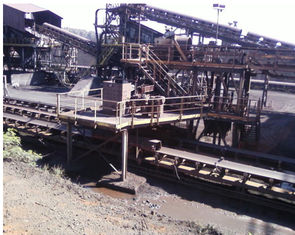
Figura 12. Vista das Instalações do Transportador de Correia Reversível. Fonte: Autor
