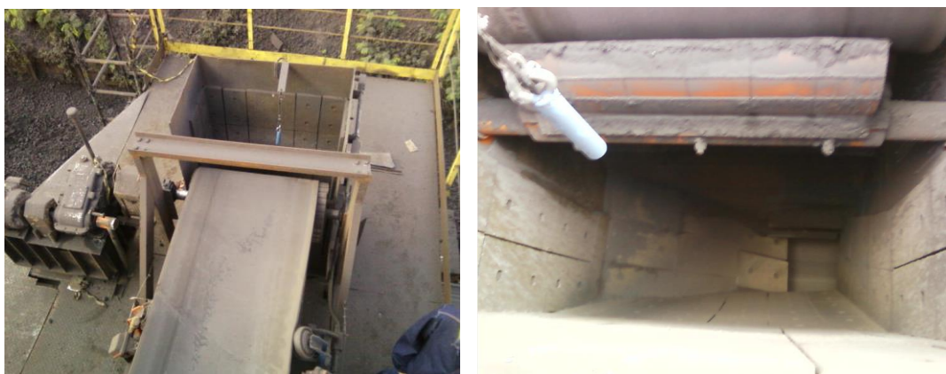
Figura 11. Chute de Descarga do Transportador de Correia Reversível. (a) Vista do Chute de Descarga e Acionamento. (b) Vista Interna do Chute de Descarga. Fonte: Autor
