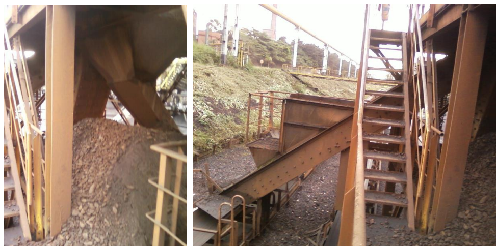
Figura 6. Acúmulo de Material na Descarga do Transportador de Correia 'X'. Fonte: Autor
