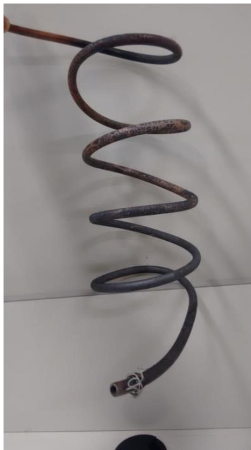
Figura (4) - Tubulação de cobre de Autor, 2016.
