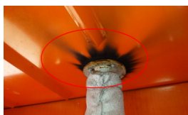
Figura 6. Vazamento de descarga dos gases para interior da casaria
