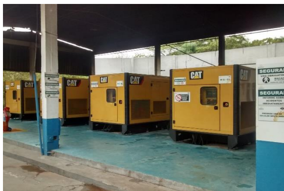
Figura 7. Usina Termelétrica de Cotijuba.
