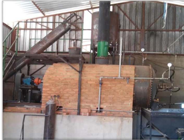
Figura 1: Caldeira Flamotubular. Fonte: Autor.
