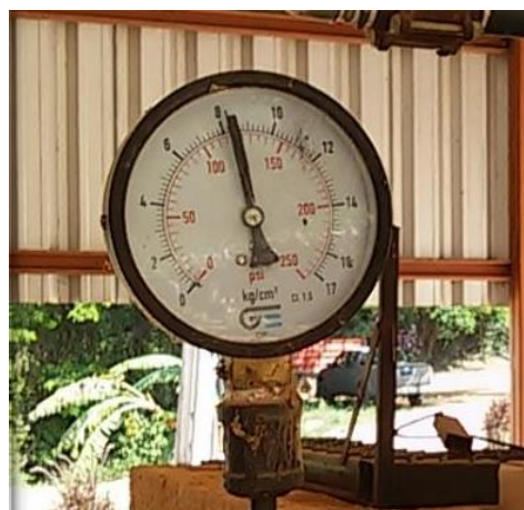
Figura 5: Medição da pressão da caldeira
