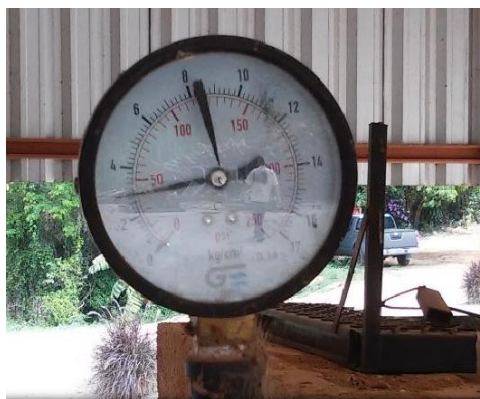
Figura 5: Medição da pressão da caldeira
