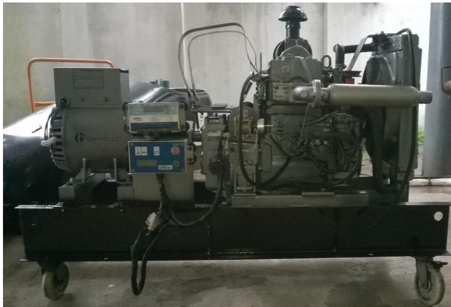
Figura 5. Grupo gerador após a realização do processo de manutenção. Autor
