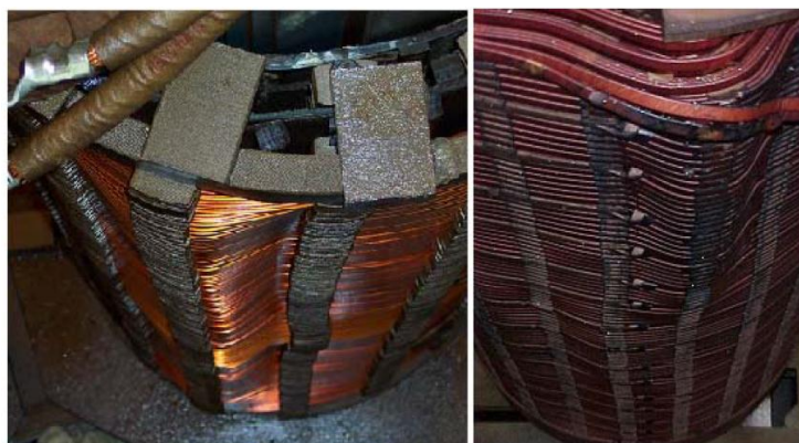
Figura 11. Danos provocado por forças axiais e radiais (Junior, 2010, p. 87).
