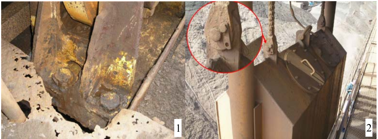
Figura 2. 1 - Corrosão acentuada nos olhais da base da lança, 2 - Ausência de parafusos na trava do pino do contrapeso.
