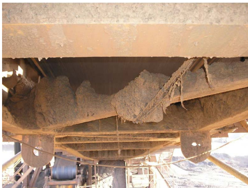
Figura 3. Incrustação na parte inferior da lança
