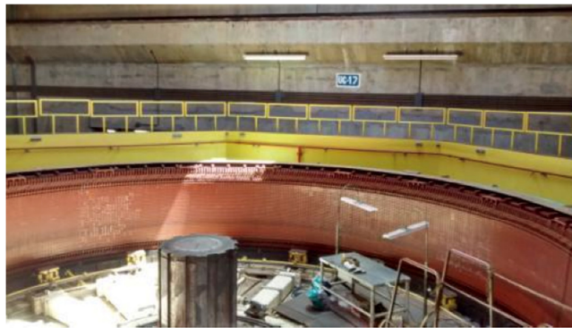
Figura 9. Unidade Geradora 17 da UHE Ilha Solteira.
