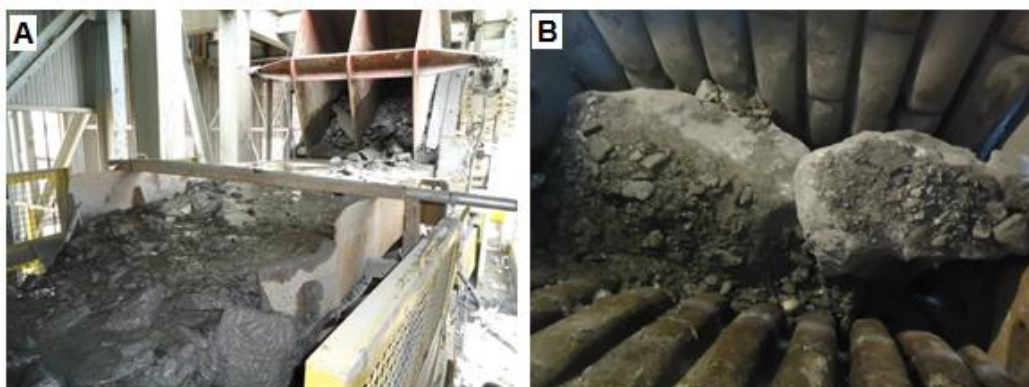
Figura 3. Entupimento por excesso de umidade (A) e entupimento por matacões (B). Acervo técnico da unidade de britagem analisada (2015).
