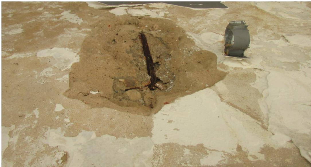
Figura 2. Corrosão de Armaduras
