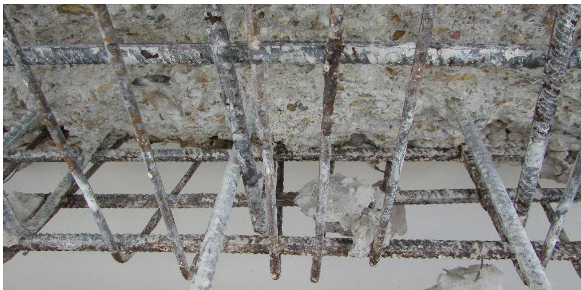
Figura 5. Armaduras em estado de deterioração
