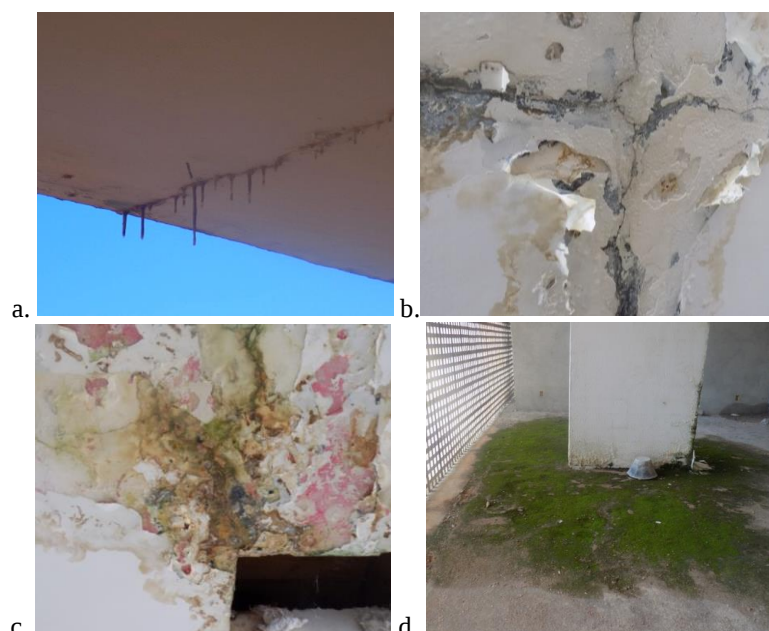
Figura 4. Patologias encontradas na edificação. a. Eflorescências visíveis nas lajes; b e c. Fissuras na superfície inferior das lajes; d. Acumulo de umidade e lodo devido às infiltrações. (Fonte: Relatório de Vistoria 013-2016-SEINST)
