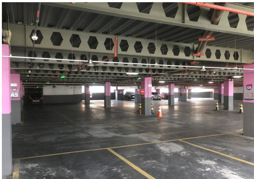
Figura 2 – Vigamento do estacionamento do Shopping Tijuca, Rio de Janeiro
