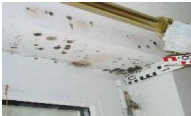
Figura 2 – Bolores provocados por condensação na região da ponte térmica. Fonte: Valerio, 2007.
